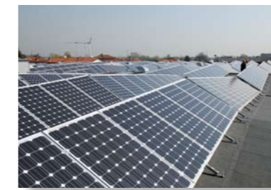
Endress + Hauser Sicestherm, 192 kW su tetti di edifici industriali, Milano
