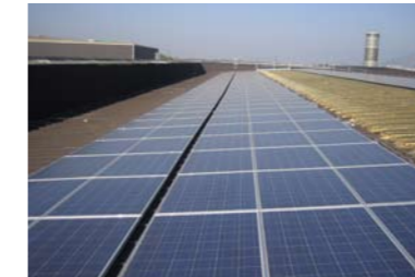
Quadrifoglio S.p.A., 296 kW su impianto di compostaggio, Firenze
